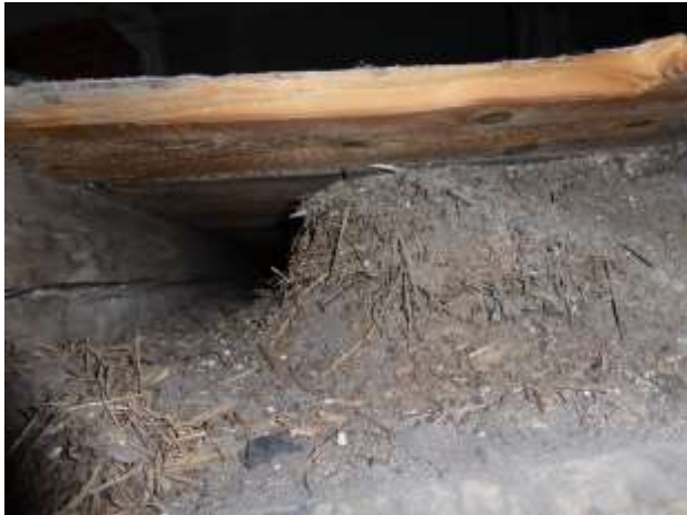
„Decke“ über der Durchfahrt; hier wohnte wohl mal ein Marder.
