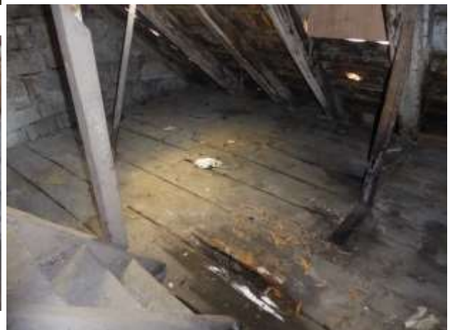
Durch undichte Stellen im First dringt Wasser ein.
