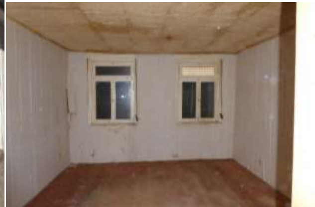
Räume im Erdgeschoß, dicht, ohne geeignete Strukturen.
