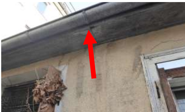
Lücke in Dachüberstands-Verkleidung, Westseite.
