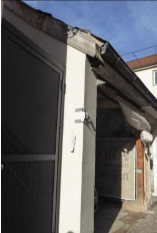
Lücke in Dachüberstands-Verkleidung an der Südostecke.
