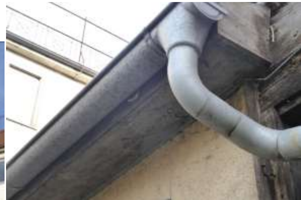
Lücken in Dachüberstands-Verkleidung über dem Eingang.
